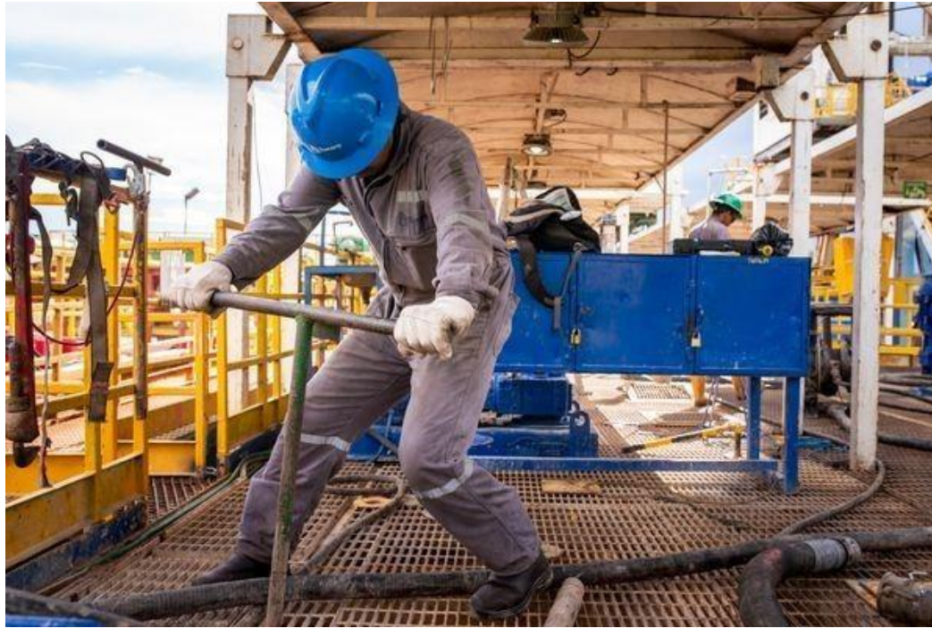
Fotografía 3. Evidencia fotográfica fluidos que generan riesgos mecánicos en planta de hidrotratamiento de combustible.
