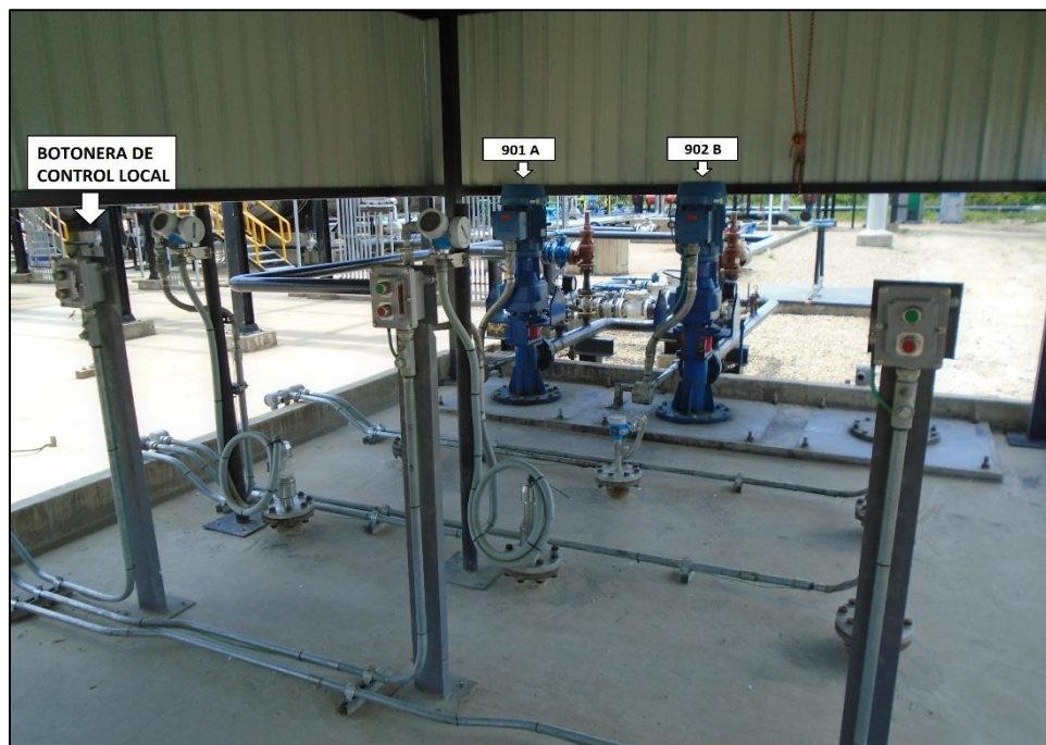
Figura 13 Bombas de transferencia
