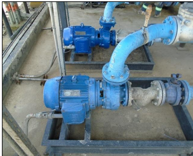
Figura 16 Bombas Centrifugas – Transf. desde Tanque de potencia hacia HPS
