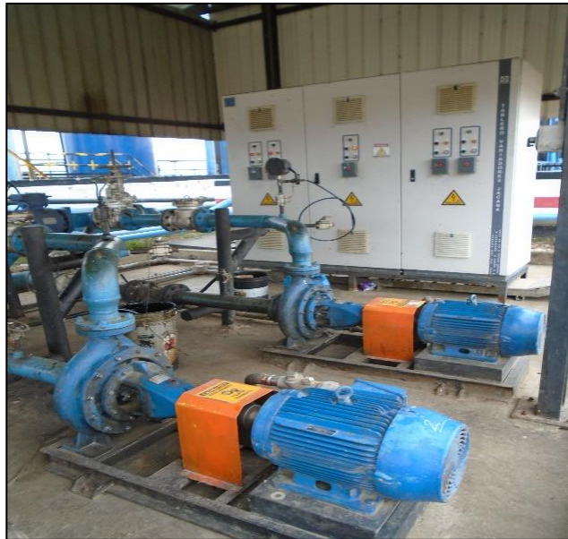
Figura 15 Bomba de transf, desde Skimming Tank hacia filtros
