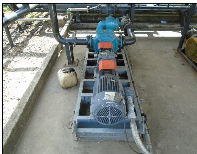
Figura 19 Bombas de transferencia – Tanques verticales
