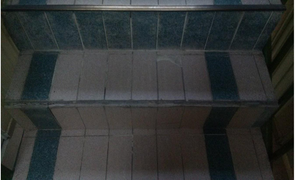
Figura 2. Escaleras donde se han perdido los pirlanes o esquineros.
