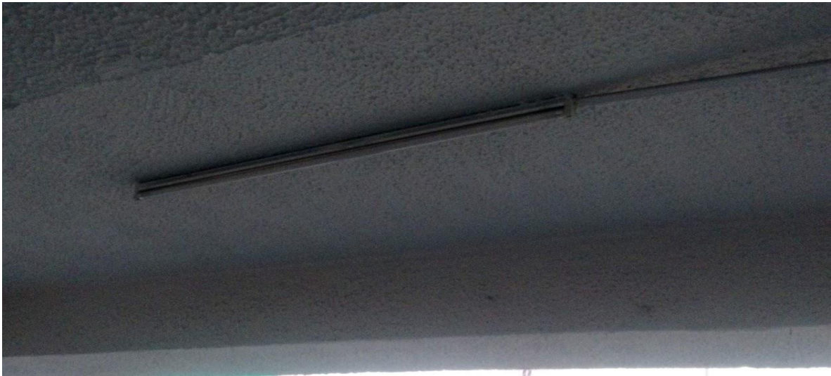
Figura 7. Luminarias instaladas de circuito en serie
