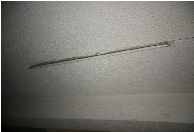
Figura 6. Luminarias instaladas de circuito en serie
