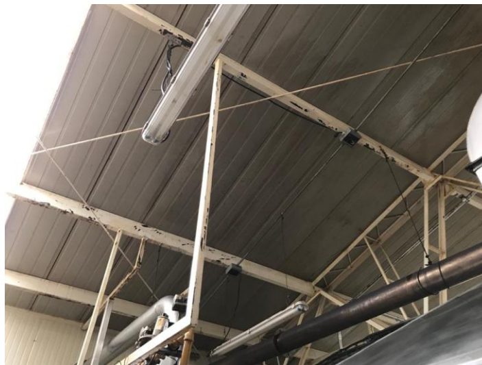
Figura 6. Correas metálicas con desprendimiento de pintura.
